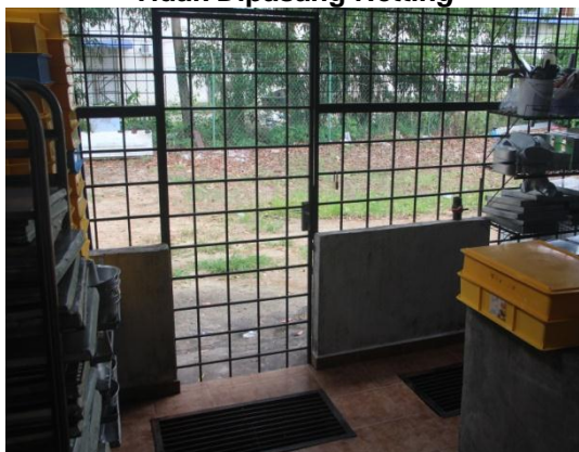
Gambar 3.5 Jeriji Besi Di Bahagian Pemprosesan Tidak Dipasang Netting
